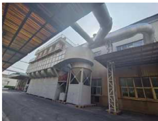
旋风除尘+布袋除尘器
